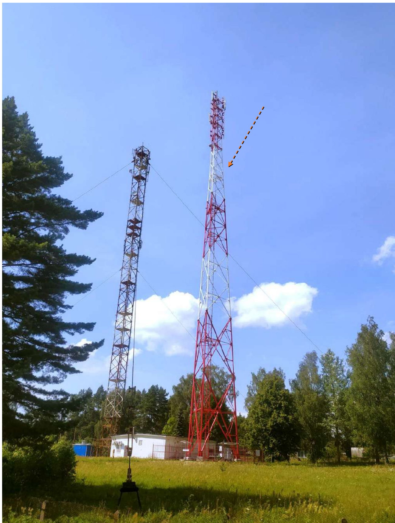
Рисунок 5 – Внешний вид существующей башни высотой 72 м СООО «Мобильные ТелеСистемы»
